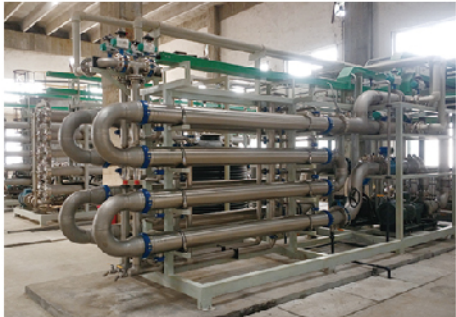
1000吨每天化工废水外置MBR系统
